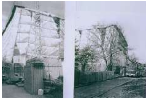
Schiefstellung der Konstruktion durch fehlende Windaussteifung.
