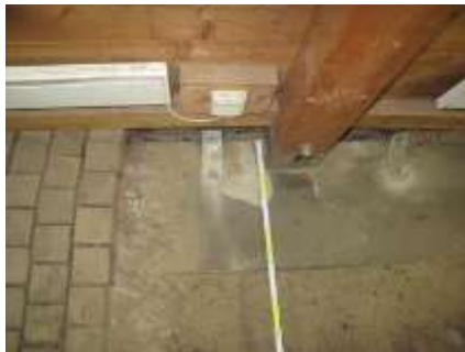
Verschobener Wandstiel infolge Holzschwindens.
