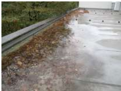
Wasseranstau auf einem Flachdach durch fehlerhafte Entwässerung.
