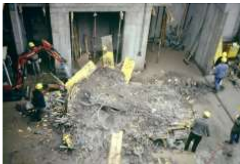
Versagen der stützenden Konstruktion der Stahlbeton-Deckenplatte.
