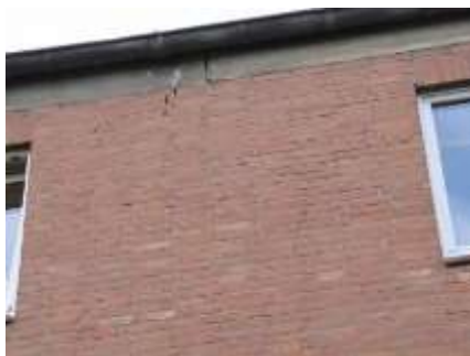
Schäden an einer Fassade durch inkonsequente Fugenanordnung.
