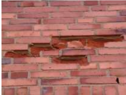
Frostschäden an einem Klinkermauerwerk.
