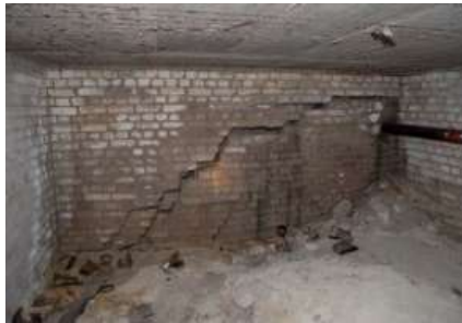
Rissbildung infolge Gründungsversagen.
