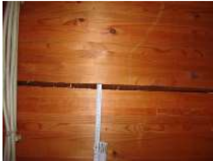
Breiter Horizontalriss entlang einer Leimfuge.
