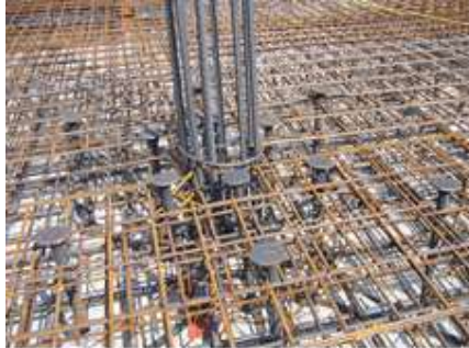
Falsche Lage der Dübelleisten, zudem mangelhafte Abstimmung zwischen Matten- und Stabstahl.
