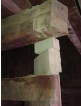
Die bauzeitliche Abstützung für den Dachgeschossausbau bestand aus zwei seitlich versetzten Kalksandsteinen. Aufgelagert waren Stahlträger der Dachkonstruktion.
