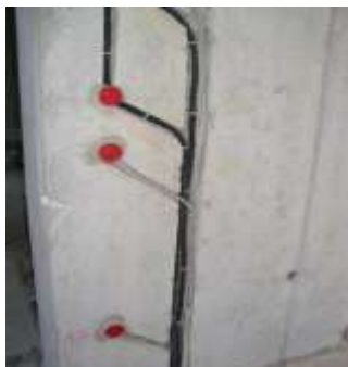
Die nachträglichen Schlitz für die Elektroinstallation haben die Flächenbewehrung teilweise durchtrennt. Durch das Durchschneiden der Zugbewehrung kann es zum Versagen des Tragwerks kommen. Für die Elektroinstallation sind Leerrohre oder Kabel innerhalb des Betonquerschnittes vor der Betonage vorzusehen.
