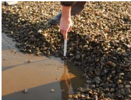
Überlast aus zu dicker Dacheindeckung aus Kies.
