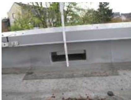
Der Notüberlauf in der Randaufkantung des Flachdaches ist von der höhenmäßigen Anordnung auf die planmäßige Entwässerung abzustimmen.
