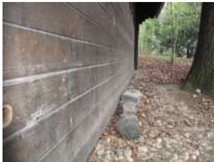
Verformte Seitenwand infolge von Schwind- und Temperaturbeanspruchungen.
