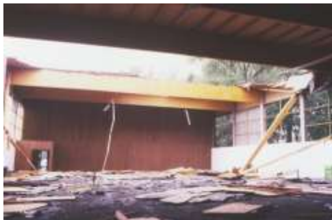
Versagen eines Dachträgers einer Sporthalle.
