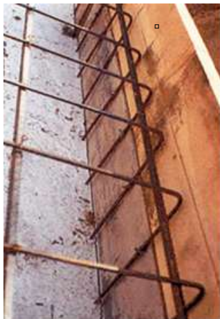
Keine Betondeckung des Bügelkorbes
