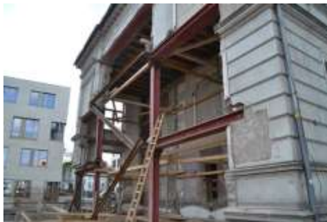
Bei dieser komplexen Bauwerkssicherung wurde ein vertikales Tragwerk aus Stahl ausgeführt. Die horizontale Stabilisierung wurde vernachlässigt und nur unzureichend als Holzverstrebung angeordnet.
